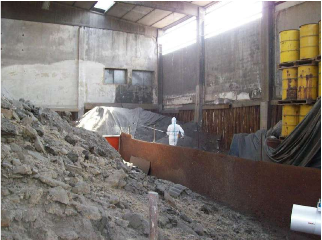
Figura 15: Polveri di abbattimento fumi contaminate a seguito di fusione incidentale di sorgente radioattiva (ARPA Lombardia)
