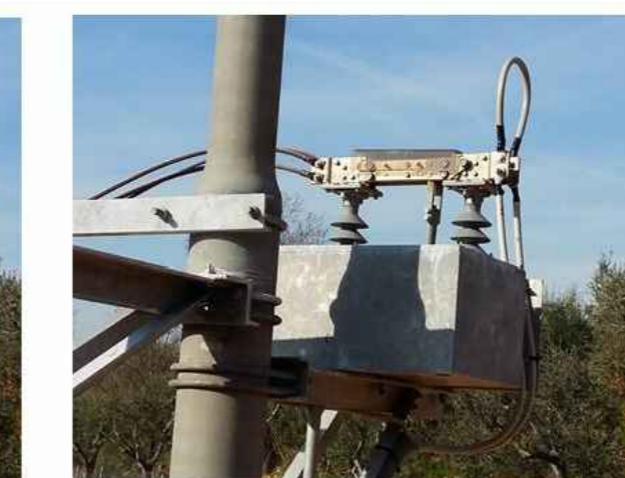
Sezionatore con lama di terra chiusa
