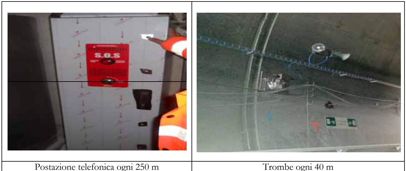
Fig. 6 –Impianto di Telefonia fissa e diffusione sonora
