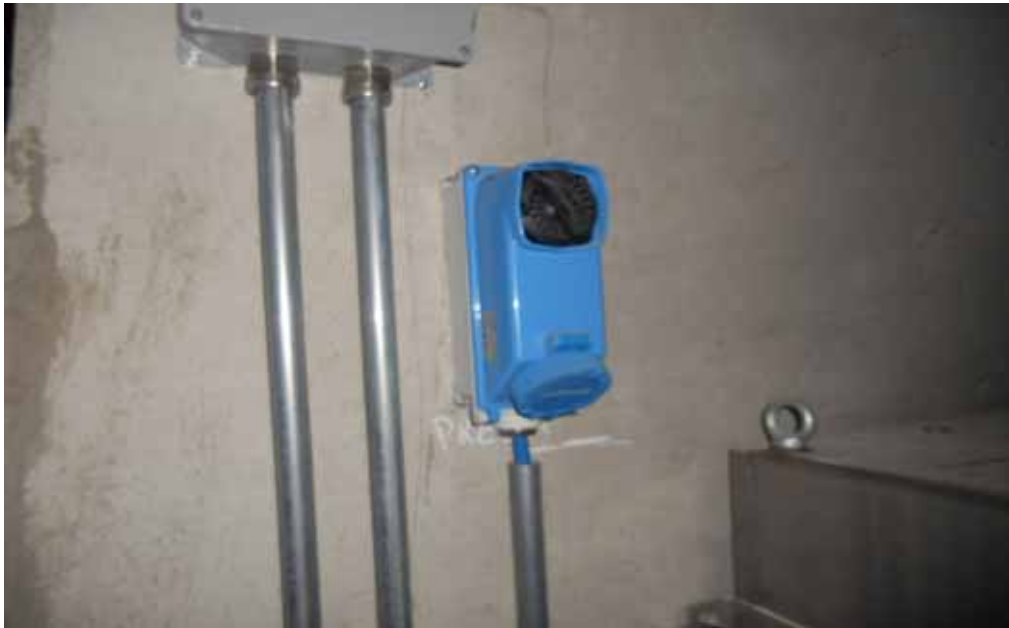
Fig. 7 – Presa elettrica a parete
