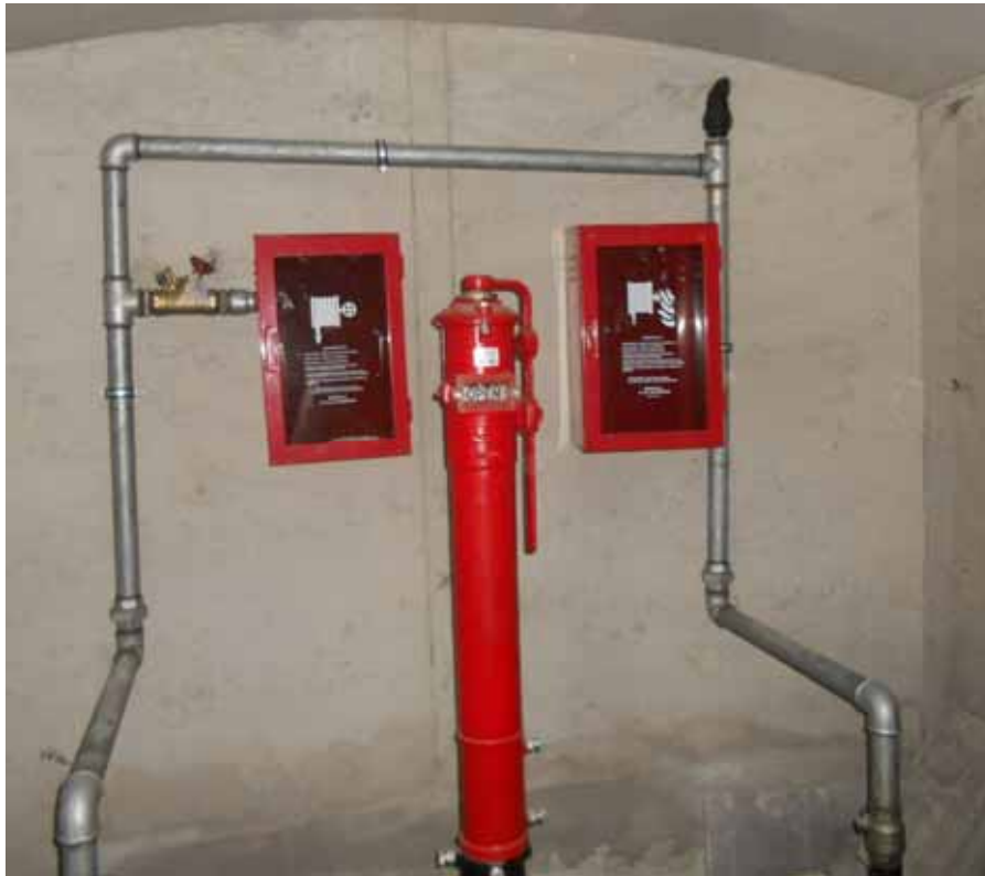
Fig. 8 - Nicchia anti-incendio con naspi UNI 45 e valvola di intercettazione condotta
